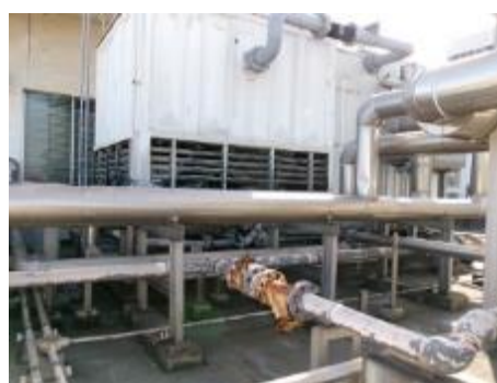
老朽化した機械設備（空調）
