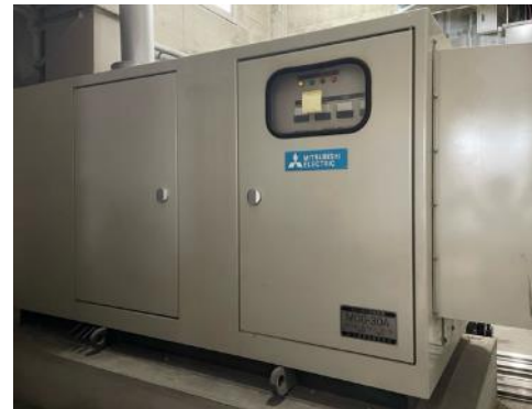
老朽化した電気設備（発電機）
