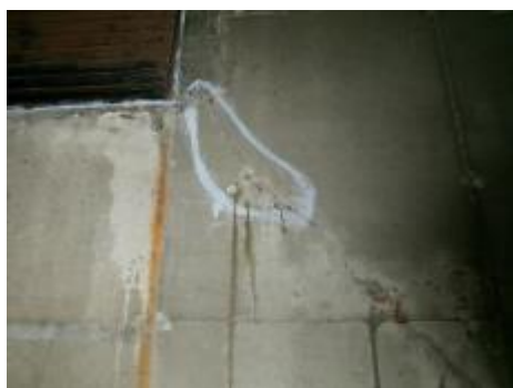
老朽化した建物
