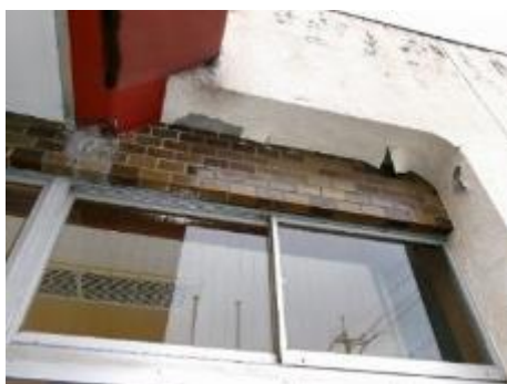
老朽化した建物
