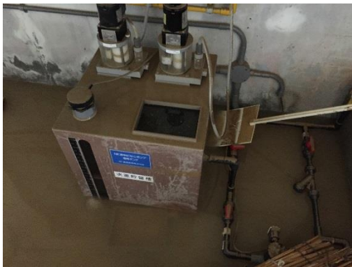
薬液注入設備
