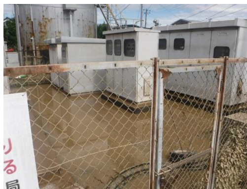
受変電・動力・計装設備
