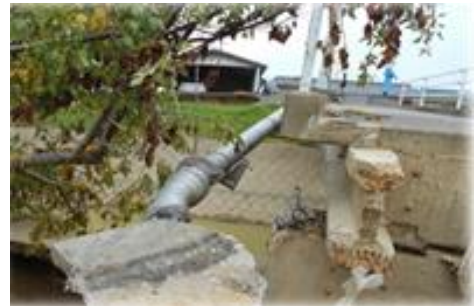
添架された送水管の被害状況
