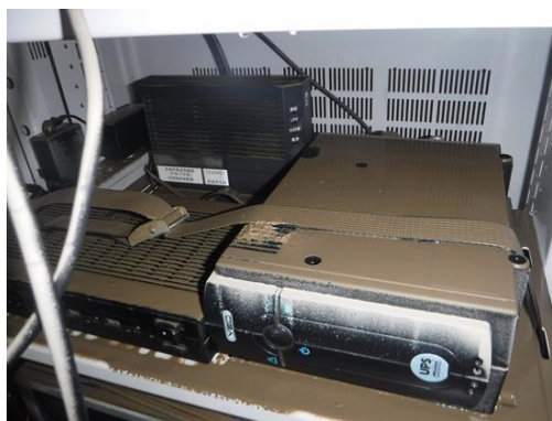
監視装置内部
