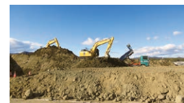
小田川の河道掘削土を有効利用し、堤防の高さまで盛土=令和4年2月
