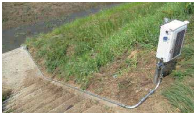
[ 危機管理型水位計の設置状況 ]
