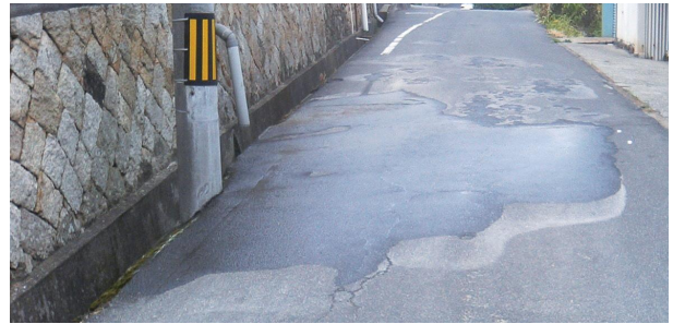
▲路上での漏水の様子
