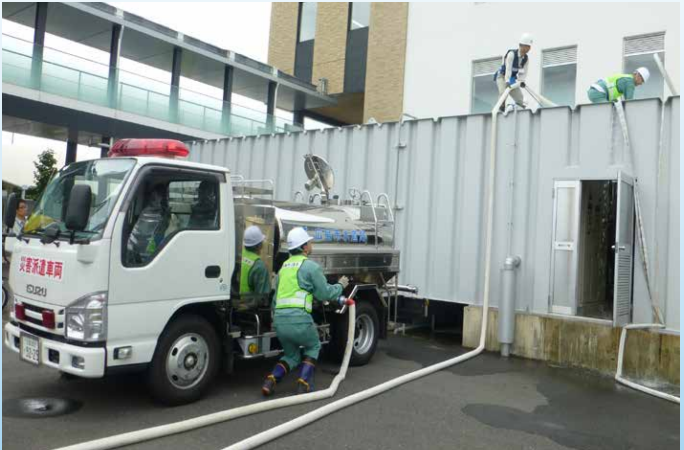
◆岡山市立市民病院で、広島市と倉敷市による受水槽への応急給水
