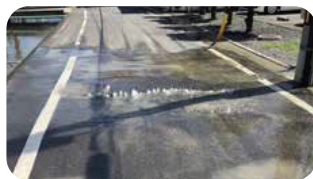
▲古くなった水道管からの漏水が路面に吹き上がっている様子
