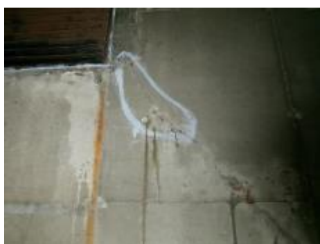
老朽化した建物
