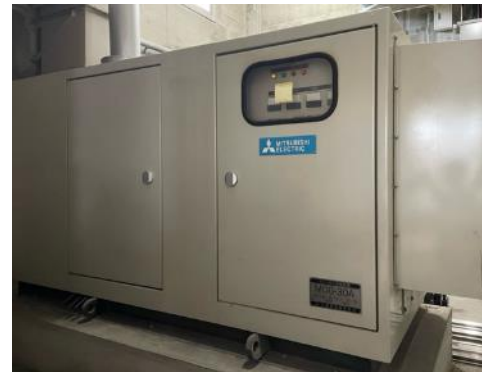
老朽化した電気設備（発電機）
