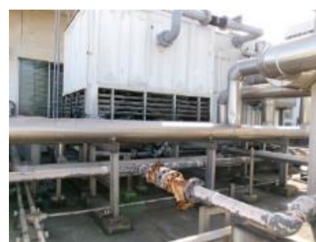
老朽化した機械設備（空調）
