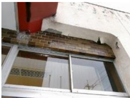
老朽化した建物
