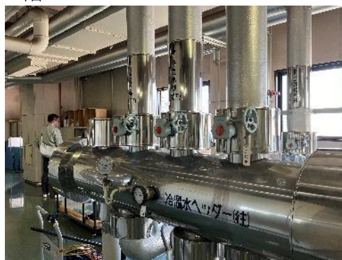
老朽化した機械設備（空調）
