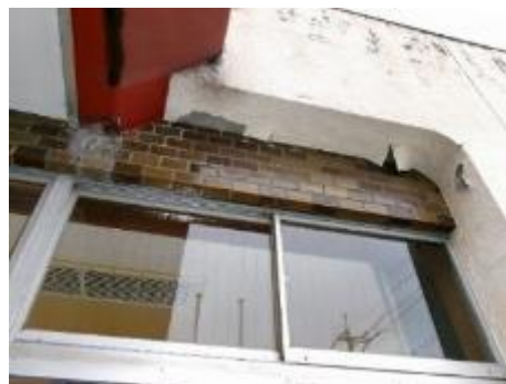
老朽化した建物
