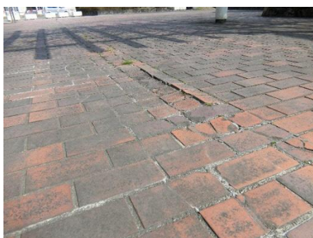
図 タイルの老朽化状況
