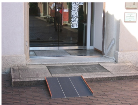
図 2-3 施設出入り口の段差解消が必要。
