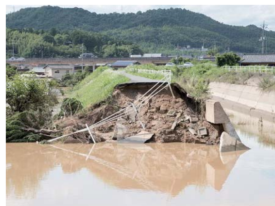
O rompimento da barreira do rio devido a brusca corrente de águas barrentas. Quando a barreira do rio se rompe, num instante as casas ficam inundadas. As áreas onde houve o rompimento, as terras deslizaram-se até chegando a demolir as casas...
