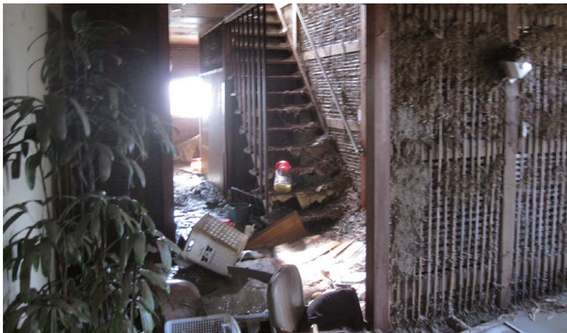
被災した建物の内部の様子
