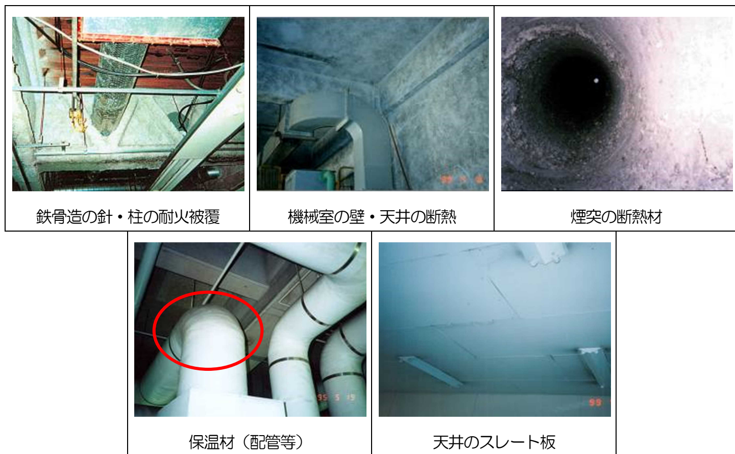
【アスベスト含有建材の例】
