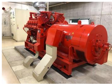
非常用発電機
