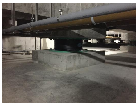
免震装置（地下）
