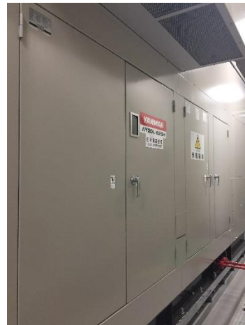
自家発電設備（6F）
