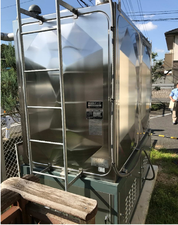
スプリンクラーのポンプユニット
