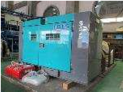
(水島下水処理場 可搬式発電機)
