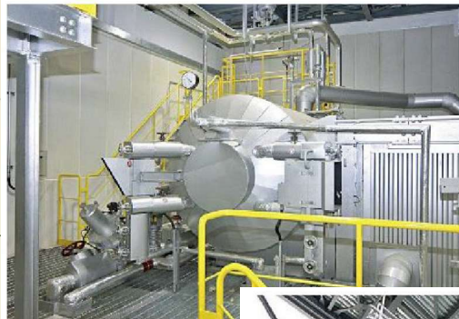
ボイラドラム
