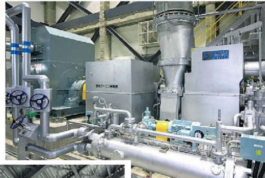
蒸気タービン発電機
