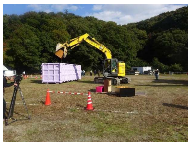
木製家具をバックホーで バツカンに投入している様子
