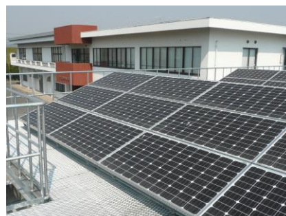
太陽光発電システム
