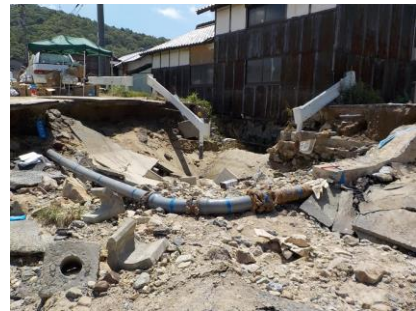
平成30年7月豪雨災害の状況
