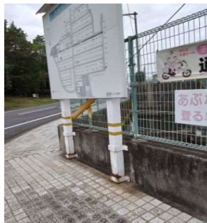
町内銘板の鉄骨腐食
