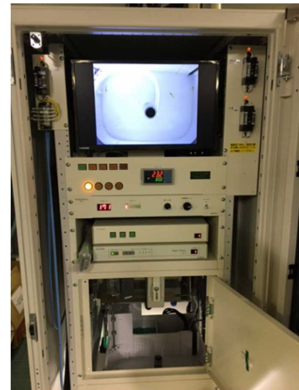
水質監視装置本体
