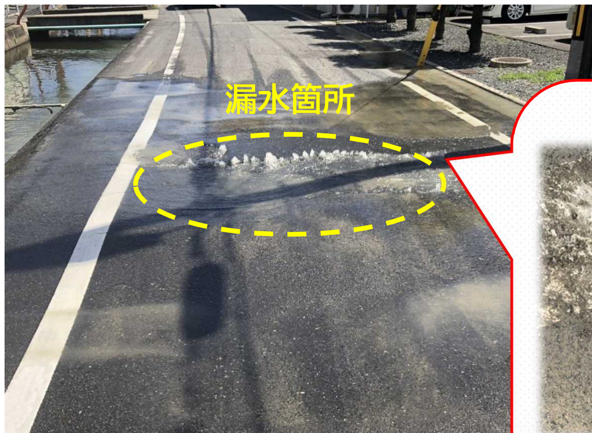
道路上で発生した漏水の様子
