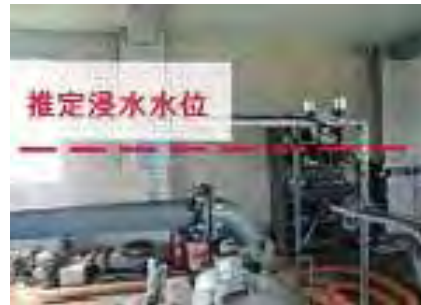
冠水により機能停止した 真備浄水場
