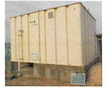
受水槽（乙島小学校）
