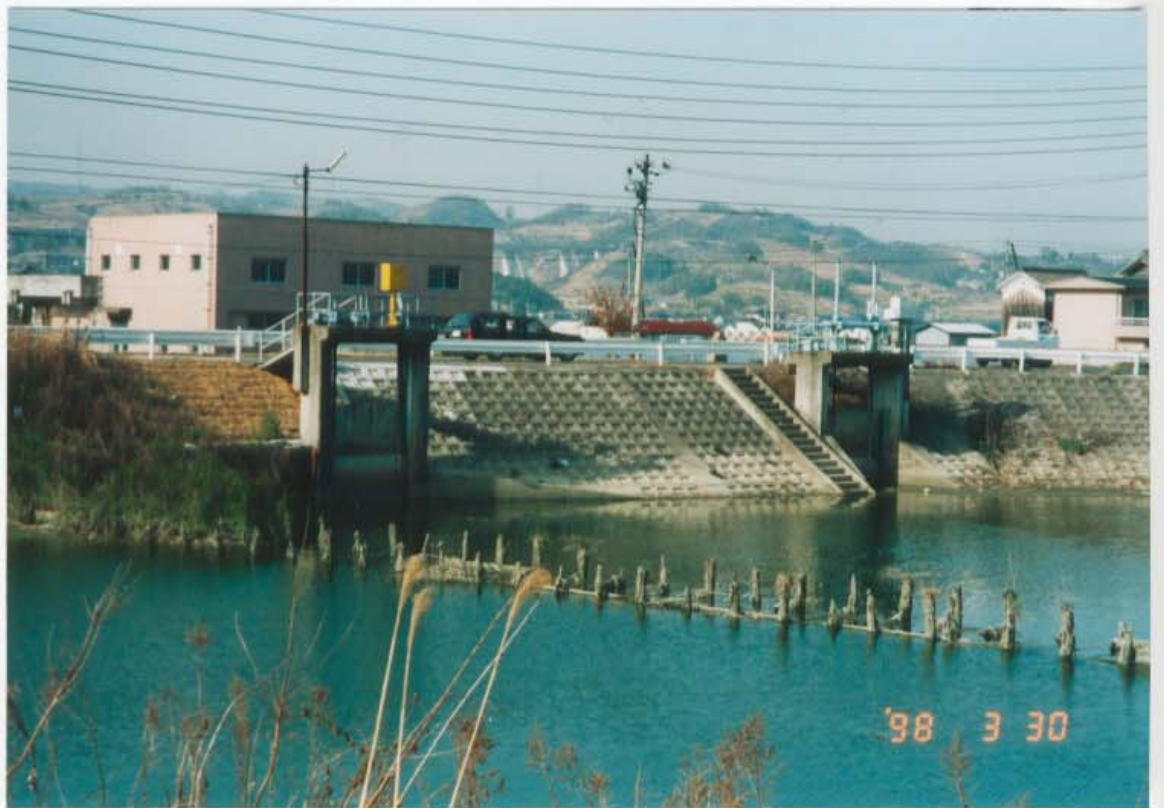
って透 みお に溜った水を排水機場南の樋門(写真下)から放出して三本松の方へ流下させる。
