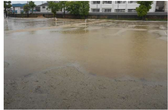
運動場の排水不良
