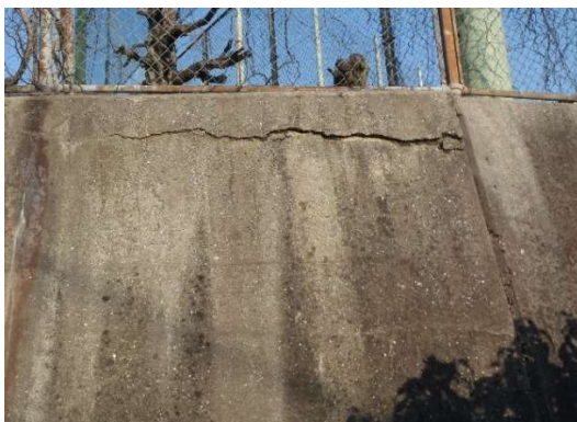
よう壁(土留め)のひび割れ
