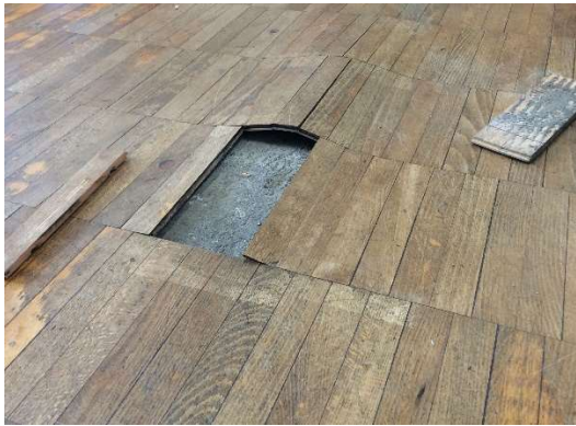
木質床材の浮き・はく離
