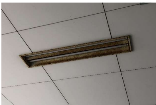
照明器具のさび
