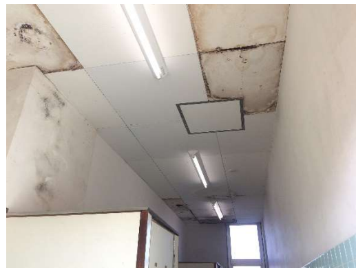
天井ボードの浮き・割れ
