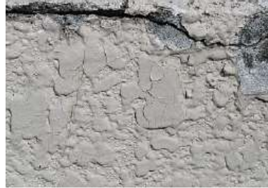
塗膜のひび割れ
