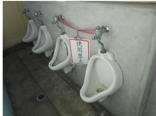
便器の排水不良
