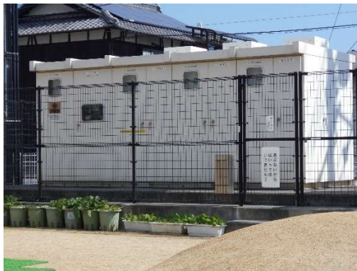
受変電設備更新
