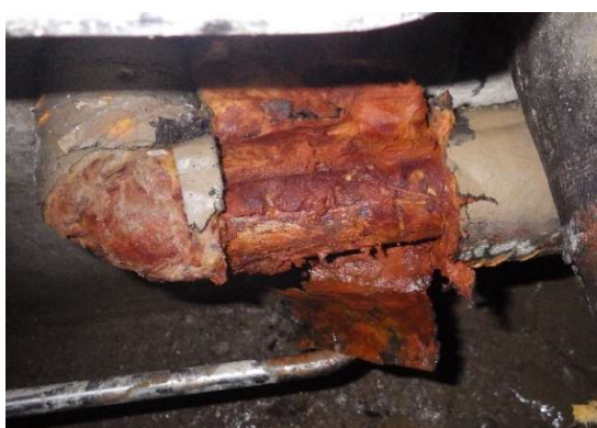
ピット内配管のさび
