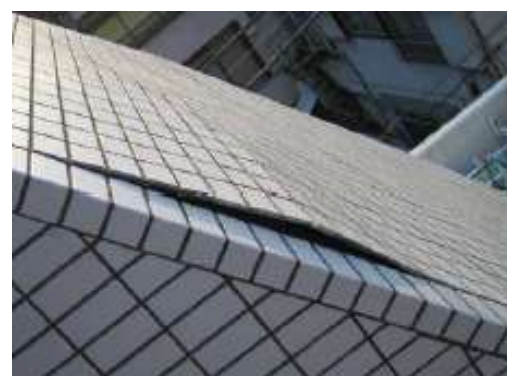
タイルの浮き・はく離
