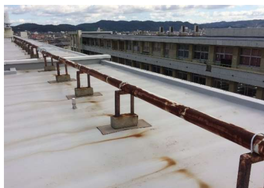
配管(保護管)のさび
