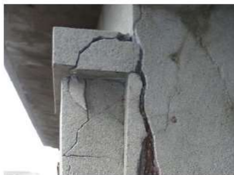
写真1 鉄筋の腐食で生じたひび割れ・はく離
