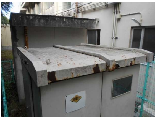
受変電設備(キュービクル)のさび
