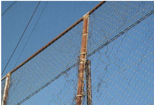
フェンス・ネット・支柱のさび
