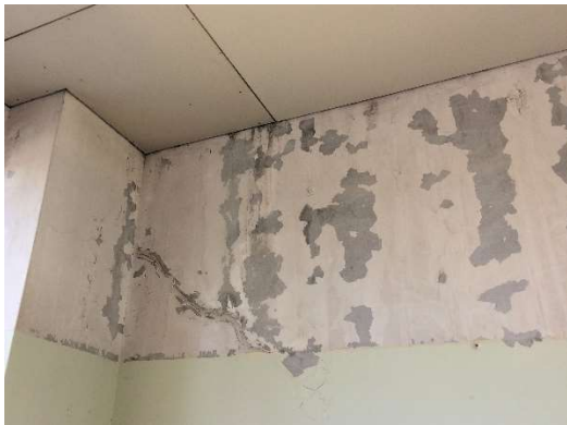
壁塗材のめくれ
