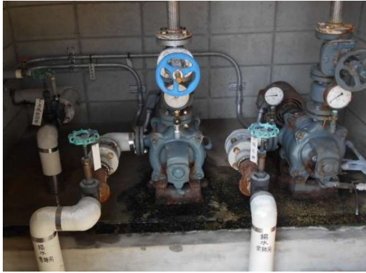
ポンプ設備の劣化・さび
