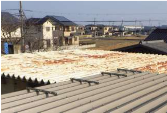
金属屋根のさび
