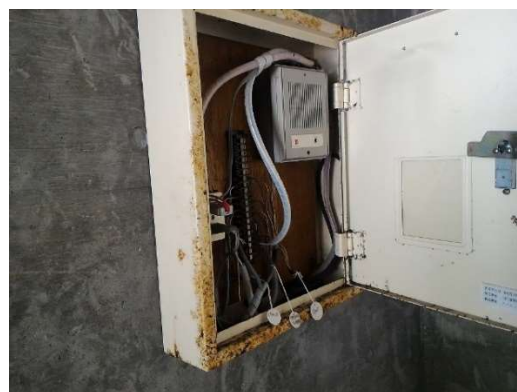
電気盤のさび
