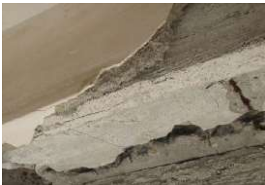
モルタルの浮き・はく離
