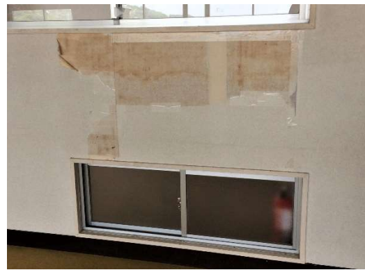
壁紙材のめくれ
