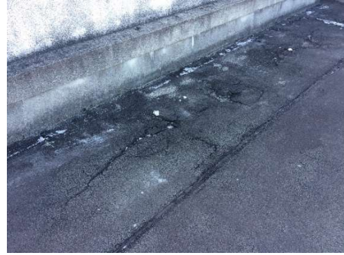
防水層のひび割れ
