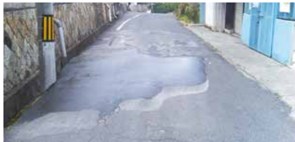
▲道路上での漏水の様子
