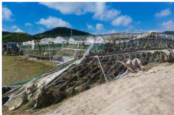
【被災したハウス】
