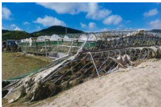
【被災したハウス】
