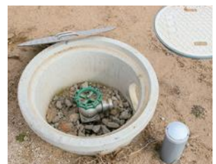
取水口(全区画完備)
