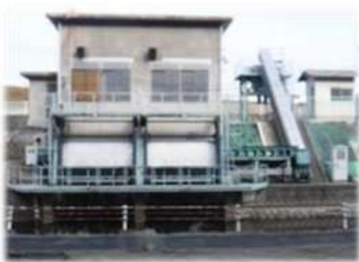
市内各地にある排水機場 適切なリスク管理のもと、更新・集約・再編・廃止など検討したうえで、戦略的な保全管理が必要です
