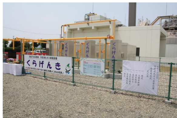
児島下水処理場消化ガス発電（愛称：くらげんき）
