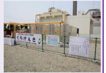
くらげんき(消化ガス発電)
