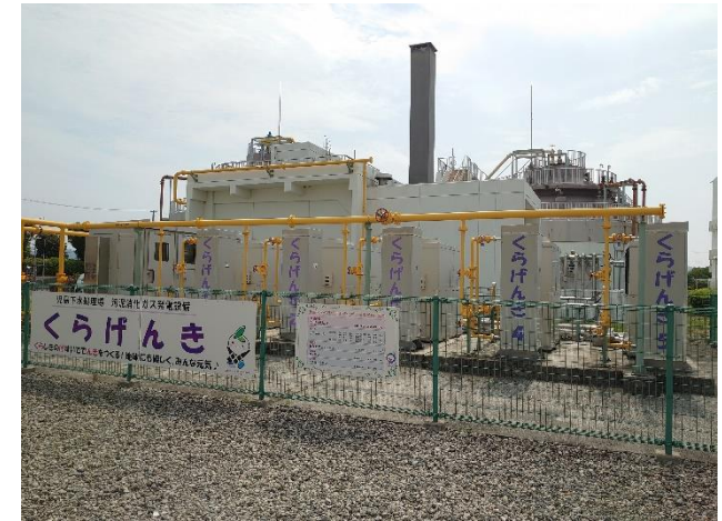
児島下水処理場のバイオガス発電設備
