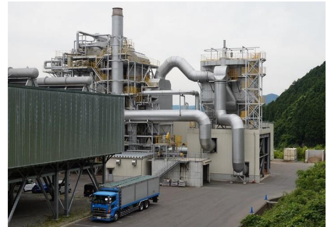
真庭バイオマス発電所
