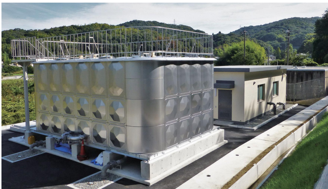
西原加圧ポンプ場(尾原地内)(撮影:令和元年10月)
